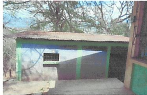
Foto 2: techo de la cocina en mal estado
