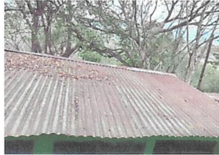
Foto 4: Techo en mal estado del corredor
