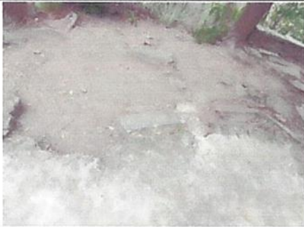
Foto 3: piso del patio en mal estado
