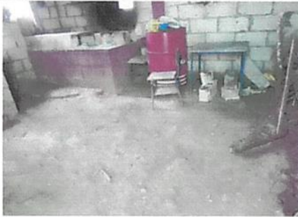
Foto 1: piso de la cocina en mal estado
